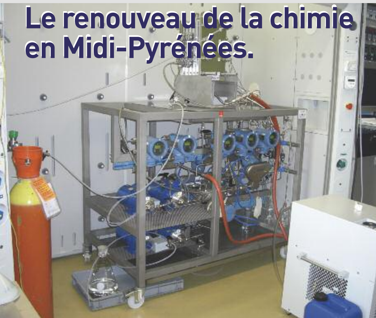
Mésoréacteur en Sic de Boostec installé à la MEPI sur le site toulousain de la SNPE Matériaux Energétiques.
